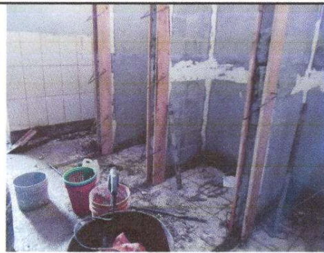
Foto 2: Área de mingitorios en mal estado, con olores fuertes.
