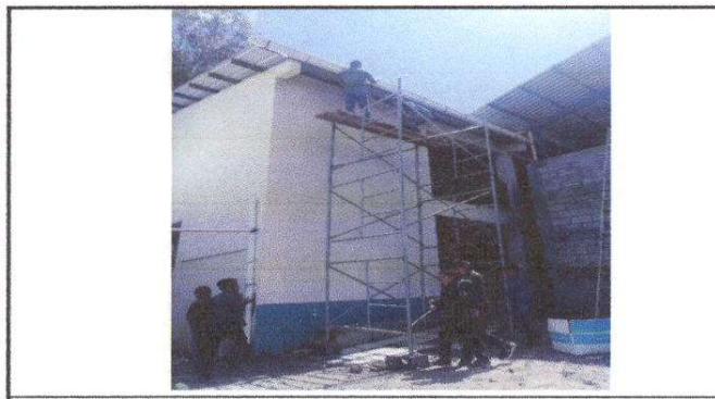
Foto 5: bajadas de agua en mal estado, rotos e incompletos.
