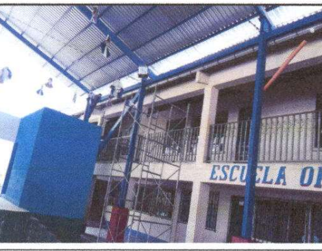
Foto 6: Bajadas de agua en mal estado, rotos e incompletos.
