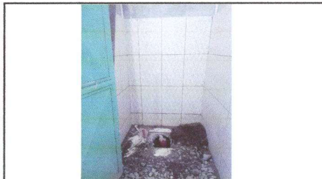
Foto 3: Inodoros en mal estado
